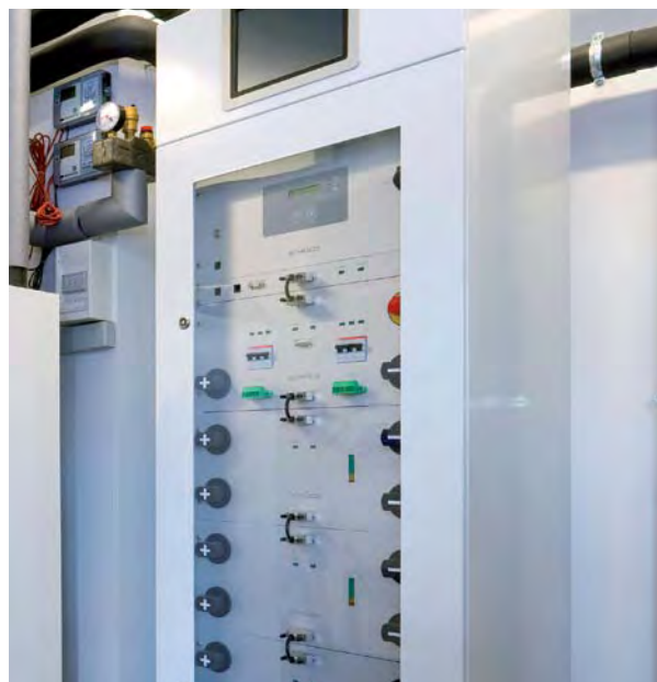
Neuer Batteriespeicher, 13,2 Kilowattstunden
