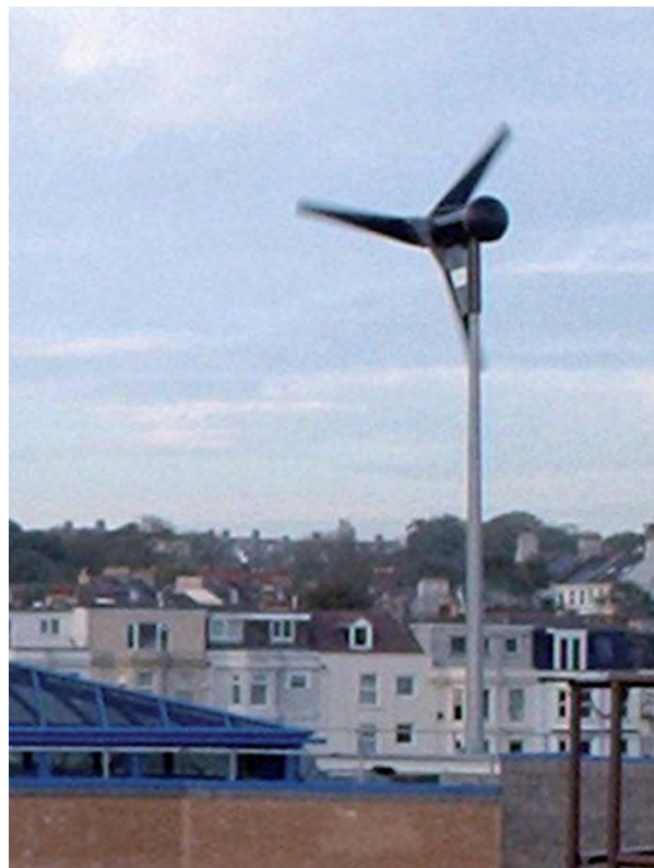
Kleine Windkraftanlagen können in windreichen Gegenden zur Eigenstromdeckung verwendet werden.
