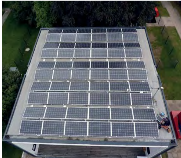
Dachfläche mit monokristallinen Photovoltaikmodulen
