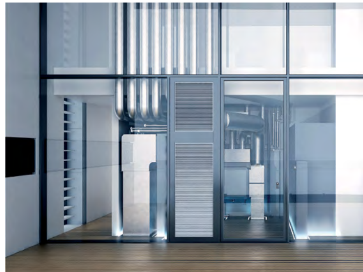
Schaufenster zum Technikraum beim Effizienzhaus Plus in Berlin
